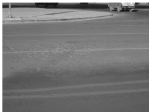
(b) 裂缝病害(龟裂)
