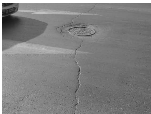
(d) 裂缝病害(纵横裂缝)
