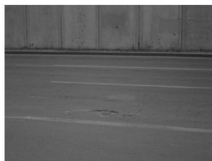
(f) 坑槽病害
