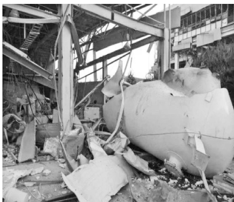
(a) 韩国制氢厂储罐爆炸事故
